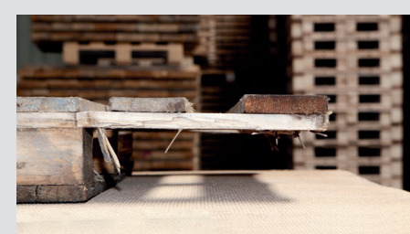
Brakujący element konstrukcyjny
